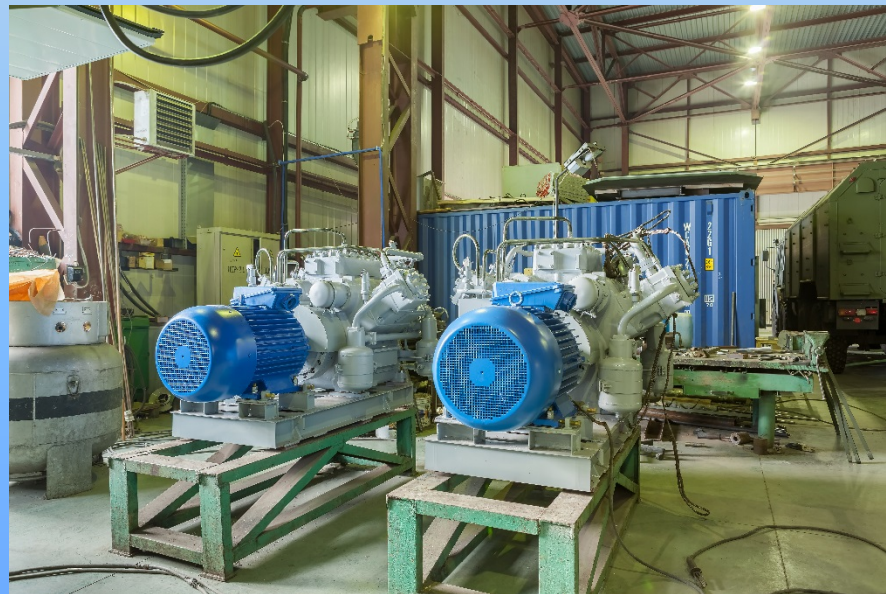
Компрессоры перед установкой в компрессорное отделение
